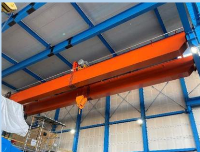
天井走行クレーン
