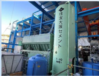
裏込め注入設備
