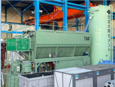
防音ハウス内設備
