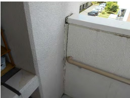
⑪ シーリングの劣化（多数）
