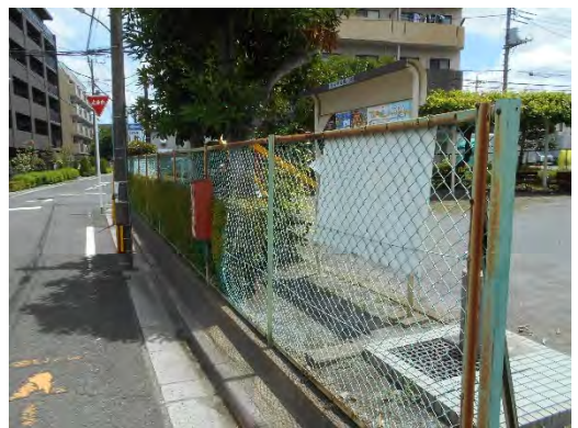
⑭ フェンスの錆
