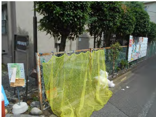
⑨ フェンスの錆
