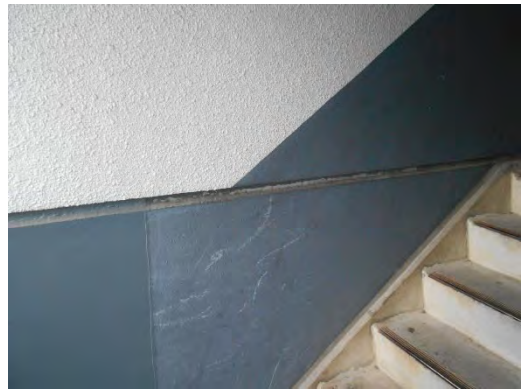
⑫ 目地の塗装劣化 (多数)
