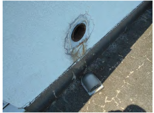
⑧ 通気口の破損 (屋上)
