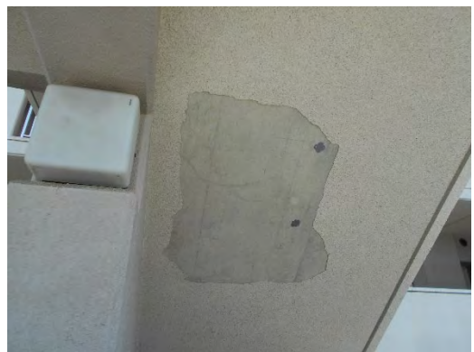
⑭ 階段上裏の塗装剥離
