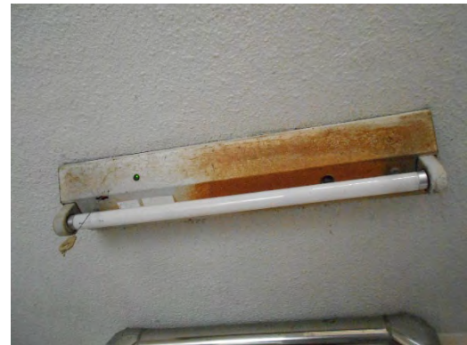
⑫ 照明器具の錆（多数）
