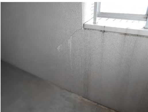
⑬ 壁のひび割れ（多数）
