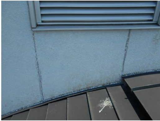
⑦ シーリングのひび割れ (多数)
