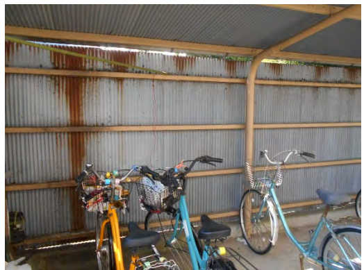
⑫ 鉄板の錆（駐輪場）
