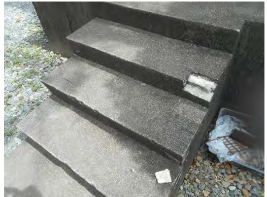
⑩ コンクリート階段の破損（旧ポンプ室）
