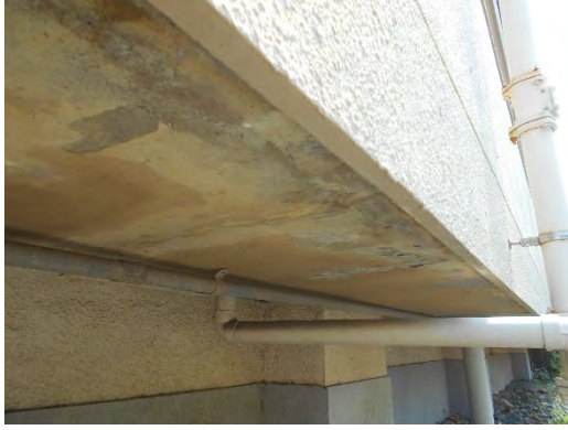
⑦ バルコニー上裏のひび割れ・エフロ
