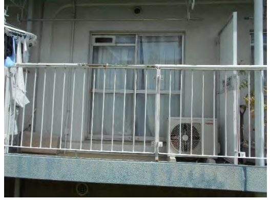
⑧ バルコニー手摺の塗装剥離 (多数)
