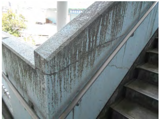
⑩ 手摺壁のひび割れ・汚れ (多数)
