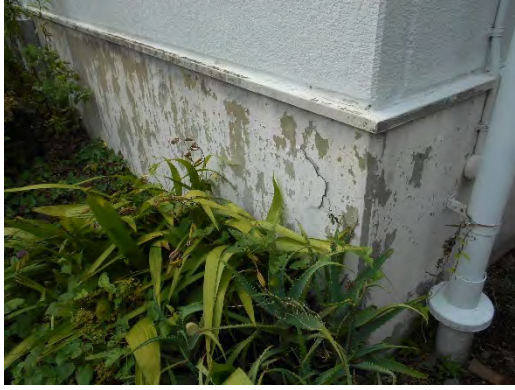
⑦ 巾木の破損・塗装剥離（多数）
