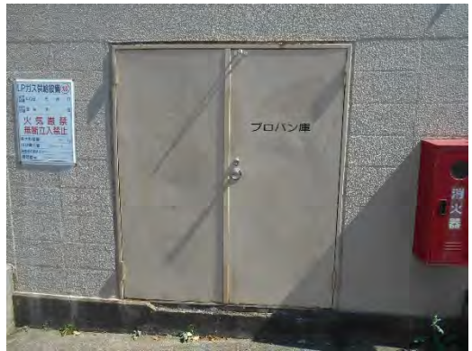
⑩ 壁・建具の塗装劣化（プロパン庫）
