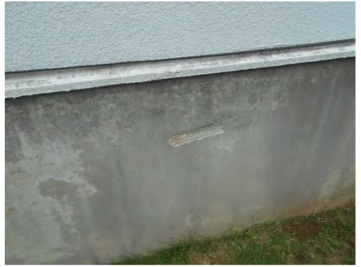
⑩ 巾木モルタルの剥離 (多数)
