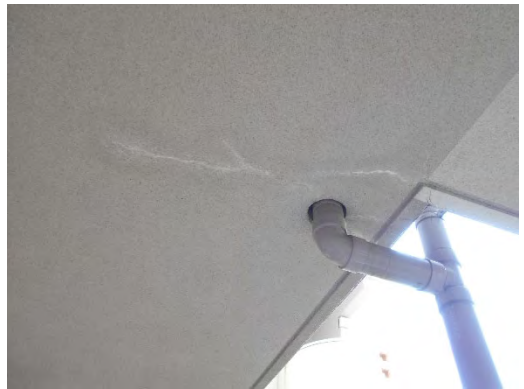
⑩ 天井のひび割れ・エフロ（多数）
