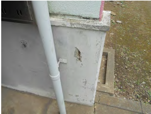
⑨ 巾木の破損・鉄筋露出（出入口部）
