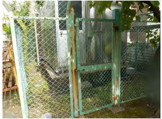
⑧ フェンスの錆
