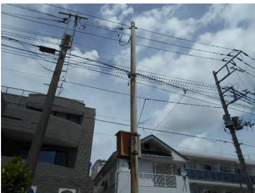
⑬ 引込柱の錆
