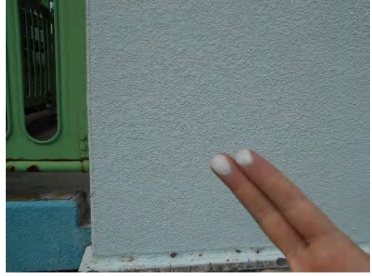
⑧ 外壁塗装の劣化（全面）
