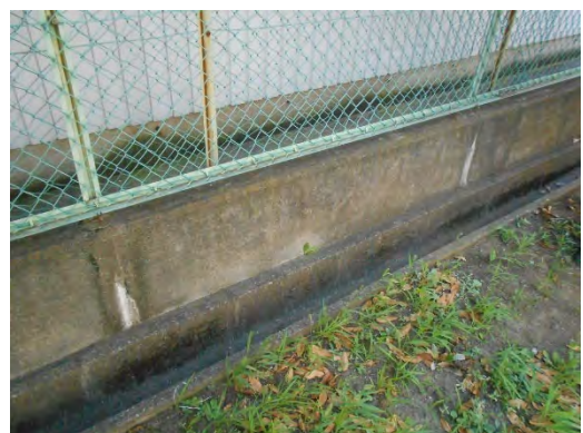
⑭ フェンス基礎のひび割れ・エフロ（敷地北側）
