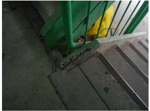
⑩ 階段桁の破損・鉄筋露出
