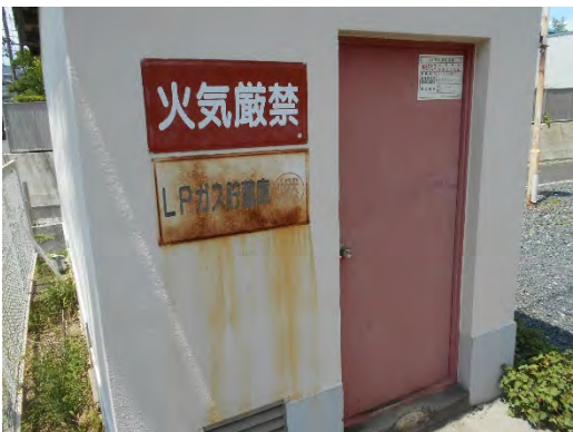
⑬ 壁・建具の塗装劣化（プロパン庫）
