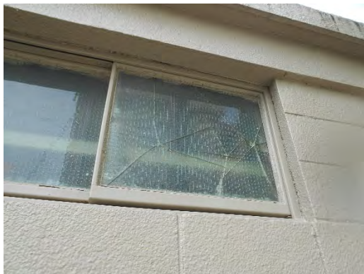
⑪ 窓ガラスの破損（旧ポンプ室）
