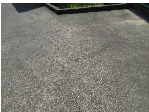
⑬ コンクリート舗装のひび割れ（通路）
