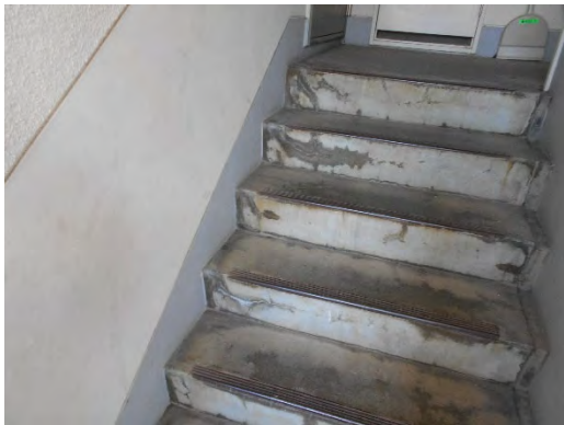
⑪ 床のひび割れ（多数）
