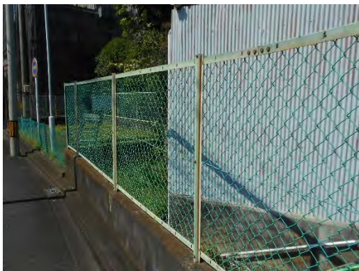
⑪ フェンスの錆
