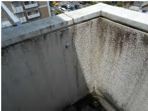
⑨ 手摺壁のひび割れ（多数）
