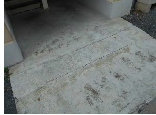
⑩ 床のひび割れ（出入口部）
