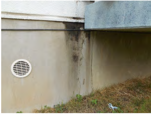
⑨ 巾木のひび割れ (南面)
