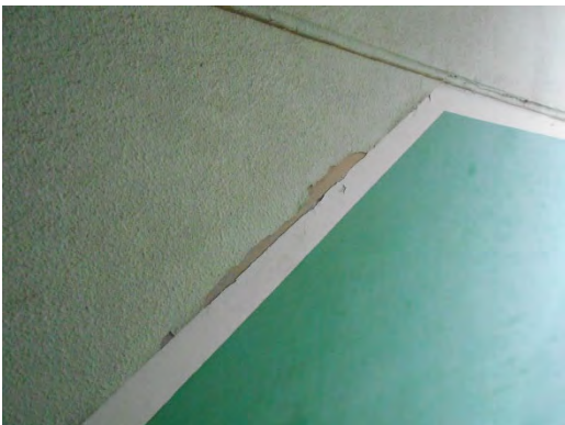
⑪ 壁塗装の剥離（多数）
