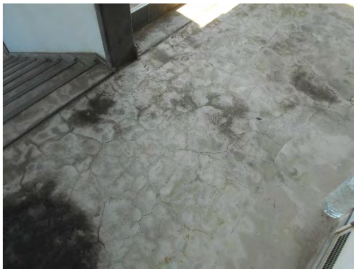
⑪ 床のひび割れ (多数)
