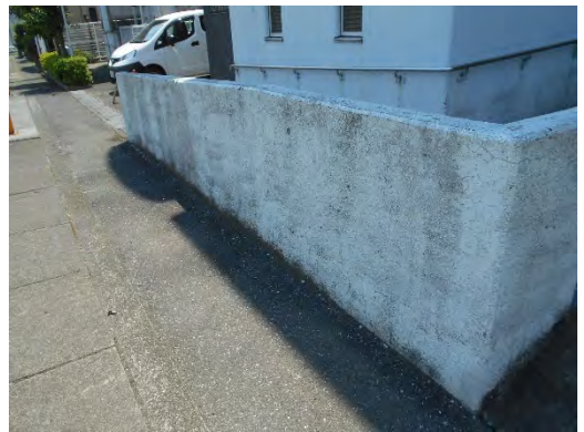
⑭ 手摺壁のひび割れ・汚れ (多数)
