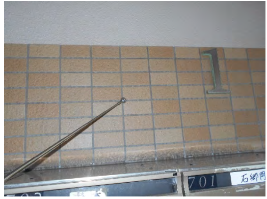
⑧ 壁タイルの浮き（エントランス）
