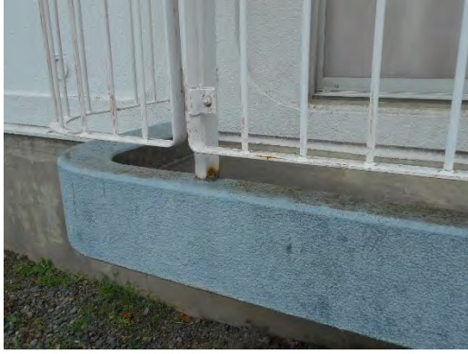
⑦ バルコニー手摺基礎の錆 (多数)
