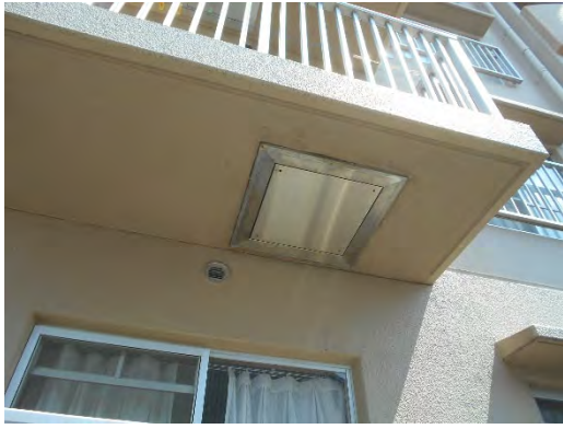
⑦ 避難ハッチの劣化
