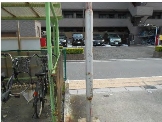
⑬ 外灯の錆
