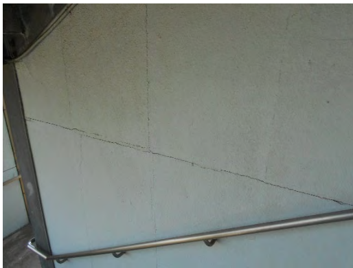
⑬ 壁のひび割れ (多数)
