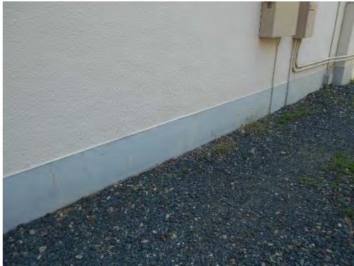
⑨ 巾木のひび割れ（多数）
