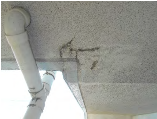
⑨ 天井のひび割れ・エフロ (多数)
