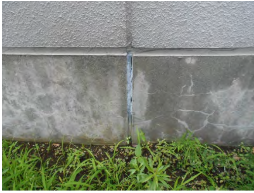
⑦ シーリングの劣化（西面）
