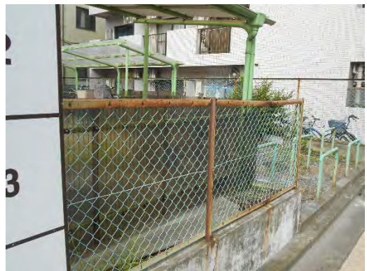
⑭ フェンスの錆
