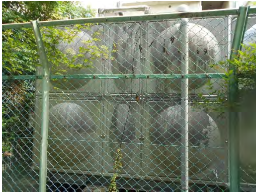
⑦ 受水槽の汚れ
