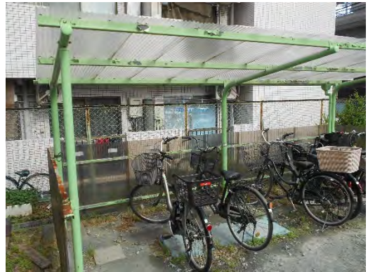
⑫ 錆・塗装剥離（駐輪場）
