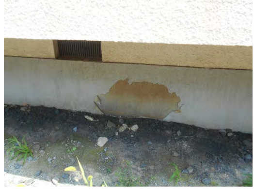
⑧ 巾木の塗装剥離（南面）
