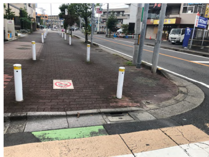
△歩車道境界の段差が大きい誘導用ブロックがなく車止め衝突するおそれがある
