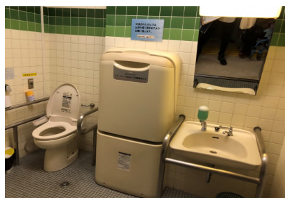
△空間が狭く、ベビーベッドなどで車いすで便器に近づきにくい
