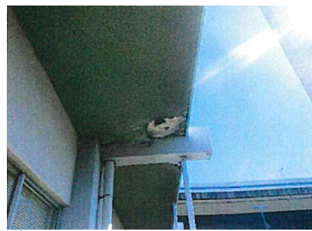
外壁塗装の劣化による剥離
