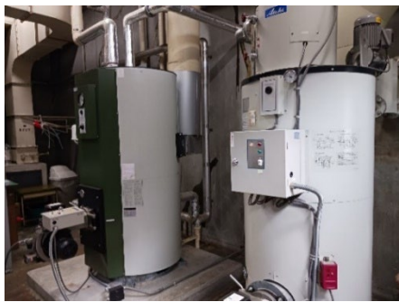
給湯ボイラーの漏水等による設備不良
