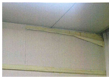
内壁仕上げ塗装の剥離
