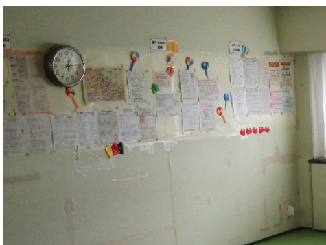
ポスター等による仕上の剥離
