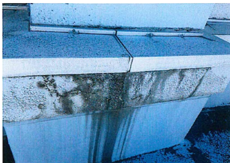
屋上仕上げ塗装の劣化
