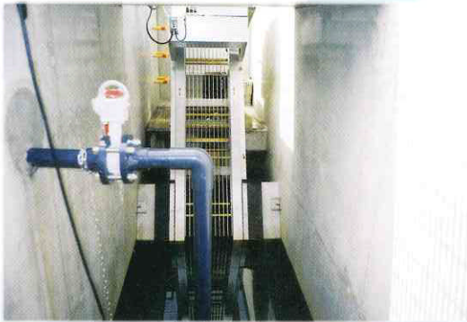
取水施設のゴミ取り装置
