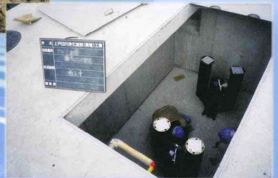
接触酸化槽に空気を送り込む装置
