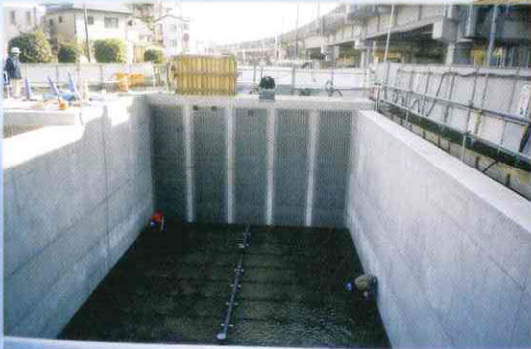
曝気付礫間接触酸化槽の内部
