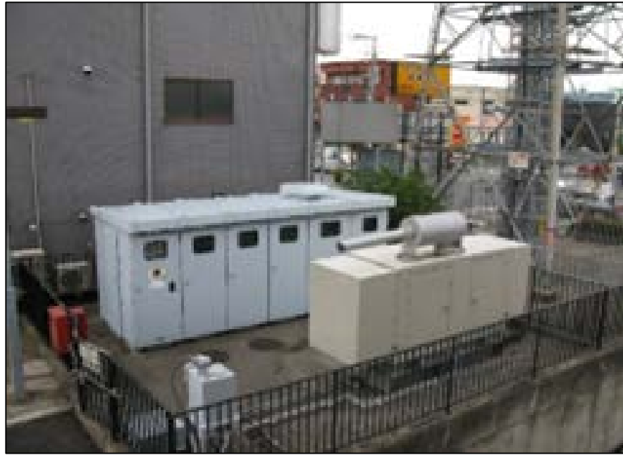
【消防本部非常用電源設備】
