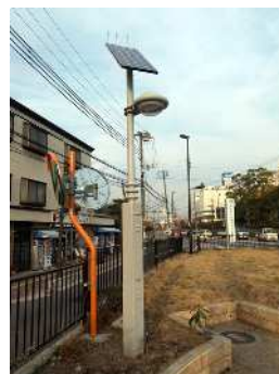
ソーラーパネルを装備した照明を広場に設置しています。
