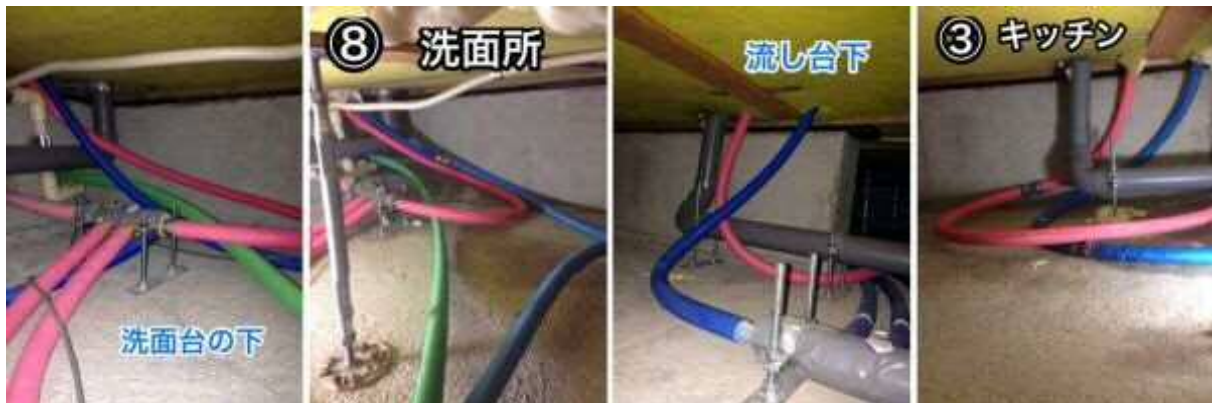
給水配管の支持が適切ではないため、ウォータハンマによる異音が起き、苦情が発生した例
