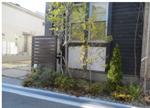
事例42 屋外空調機を、通りから見えにくい場所に設置している。
