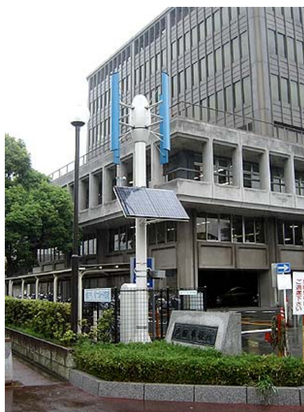
市庁舎前の風力・太陽光発電装置
